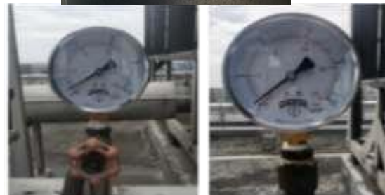
Gambar 8 Kerja VSD terpasang di Pompa
