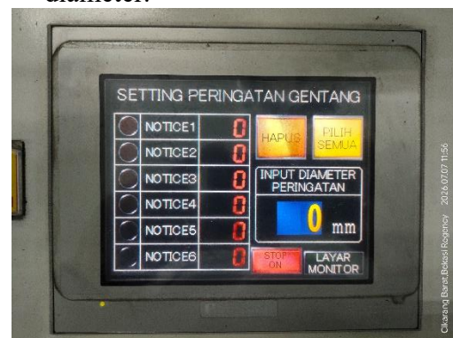
Gambar 3. (Menginput data ke panel kontrol)
